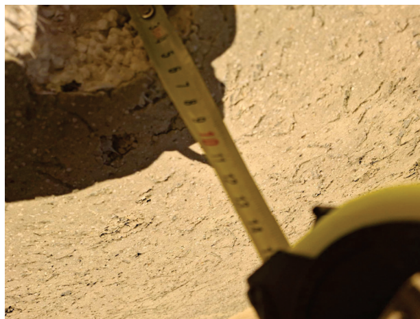
Slika 5: Obstoječa 5 cm toplotne izolacije (stiropor) na čelnih fasadah
